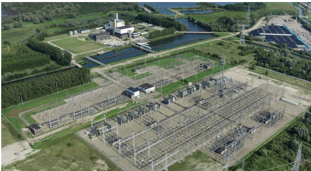
Afbeelding 4.1 380/150 kV-hoogspanningsstation in Diemen (bron: TenneT)
