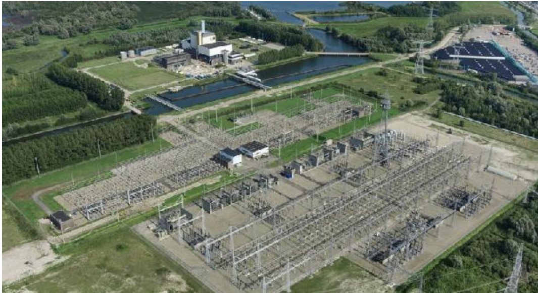
Afbeelding 1.2 380/150 kV-hoogspanningsstation in Diemen (bron: TenneT)
