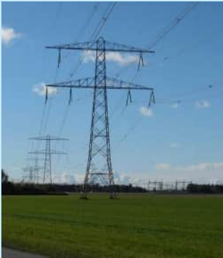
150kV solo steunmast Donau
