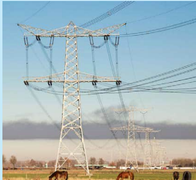
150kV hoekmast Donau
