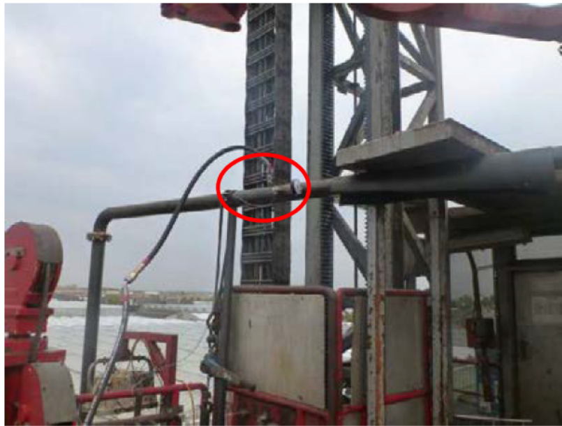
Figure 4: Probenahmestelle Drehtisch Bohrung Honselersdijk GT 2
